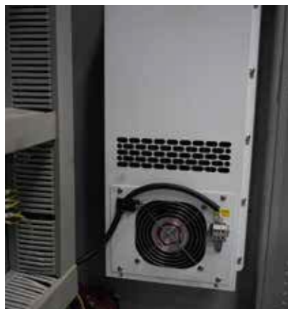
Ar-condicionado do gabinete elétrico
