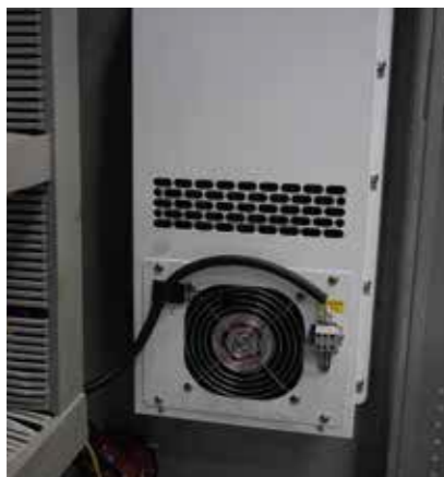
Ar-condicionado do gabinete elétrico
